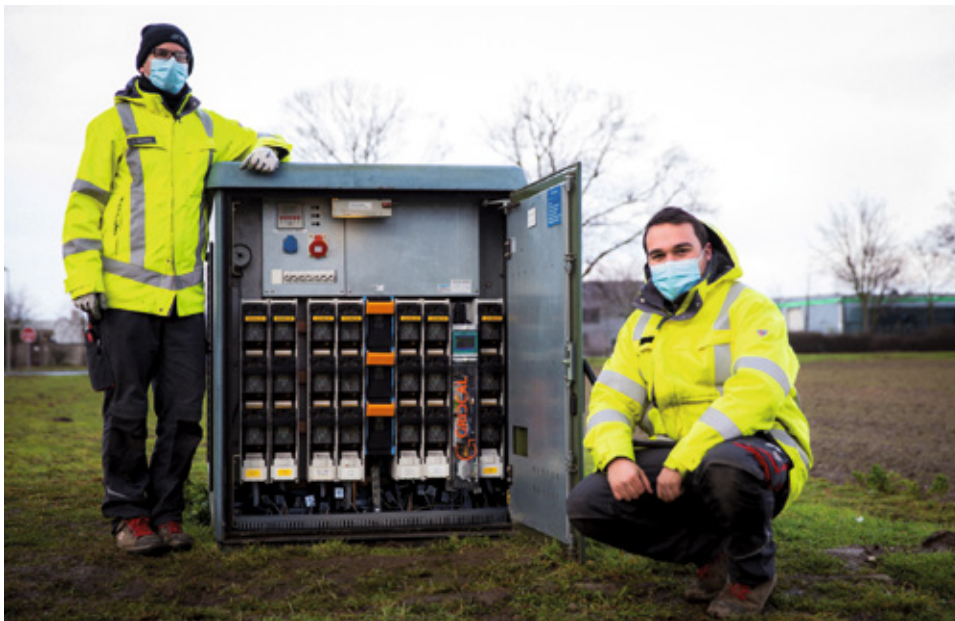
Bild 1. Umsetzung auch in den kleinsten ONS durch Direktmontage auf dem NS-Gerüst Quelle: NGN
