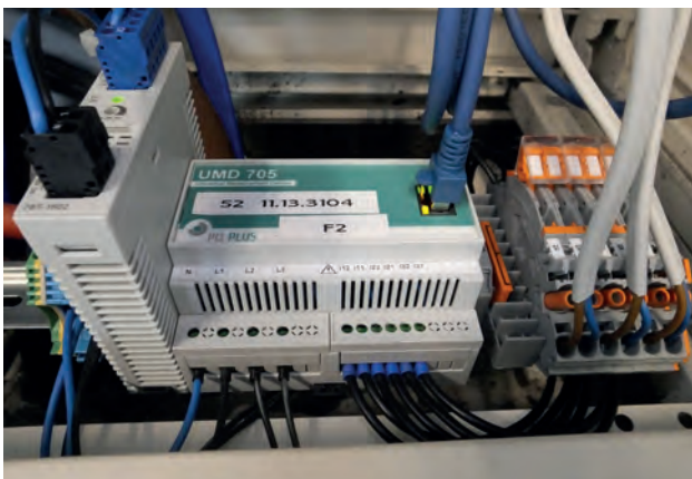
Der Ausgang der Kabelumbauwandler wird über Stromwandler-Trennklemmen auf die Messgeräte UMD 705 geführt
