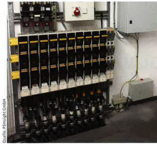
Bild 2. GridCal-System in einer Gebäudestation
