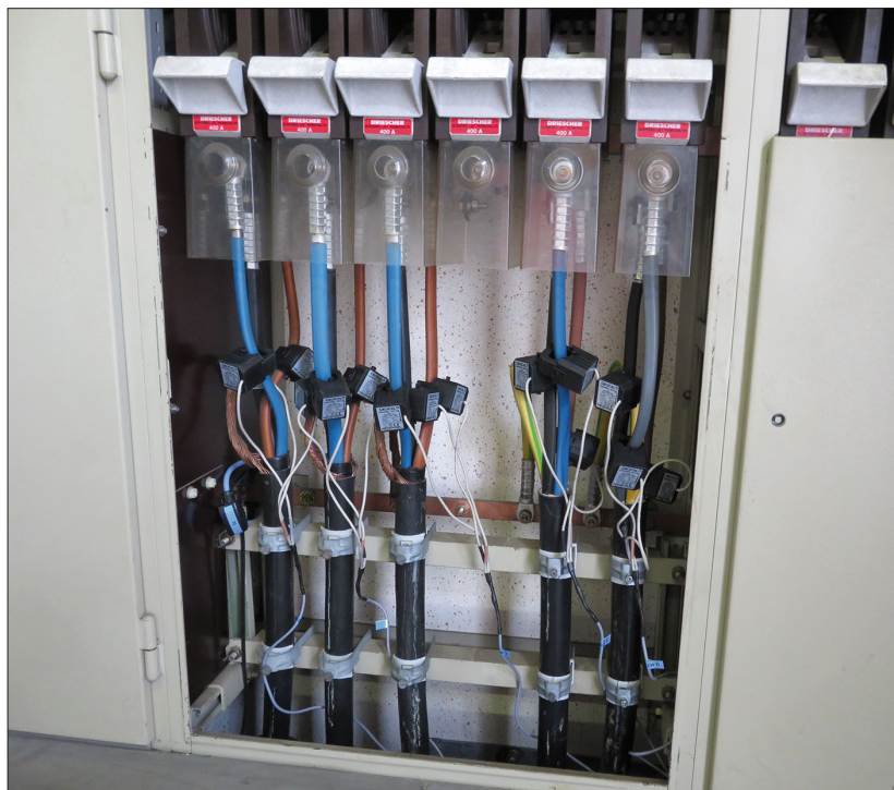
Bei der GridCal-Lösung werden nicht nur der Transformator, sondern auch die Niederspannungsabgänge mit den Leistungsflussrichtungen gemessen
