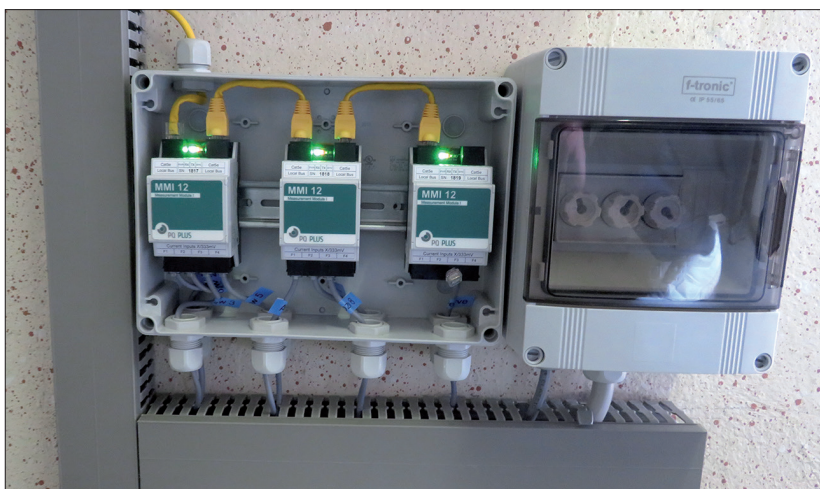
Abgangsmessmodule erfassen die Messdaten der Abgänge
