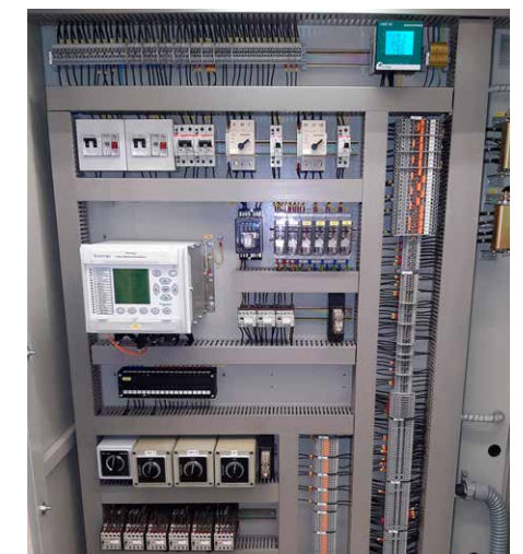
UMD 96 EL von PQ Plus übergibt die analogen Messdaten aus den Mittelspannungszellen an den GridCal-Node. (Foto: Redinet Burgenland GmbH)
