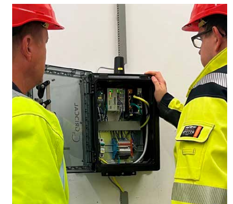
Die Mittelspannungszellen im Schaltheus konnten erfolgreich eingebunden werden. (Foto: Redinet Burgenland GmbH)
