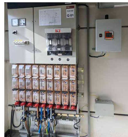
Schnell installiert, ermöglicht der GridCal-Node (oben rechts) das Echtzeit-Monitoring des Zeitzer Niederspannungsnetzes. (Foto: Redinet Burgenland GmbH)
